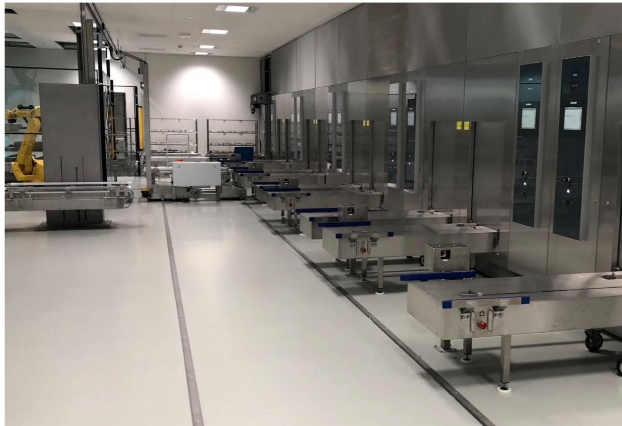
Eksempel på automatisk innlastanlegg for autoklaver
