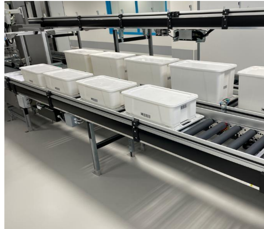
Eksempel på transportbaner for oppstilling av tomme kasser på transportplater
