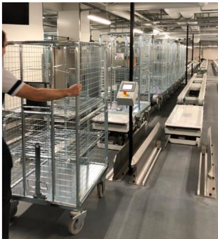
Eksempel på stasjoner for AGV eller manuell levering eller utlevering av vogner
