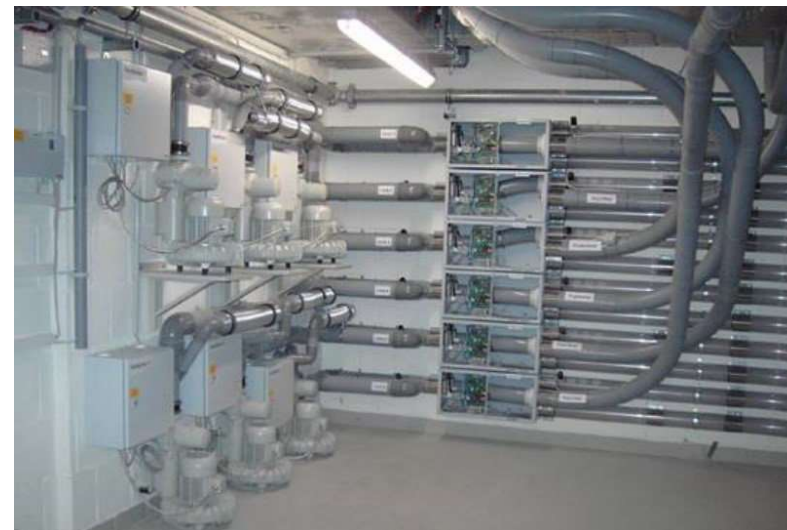
Figur 111: Eksempel på vekslesentral for rørpost.
